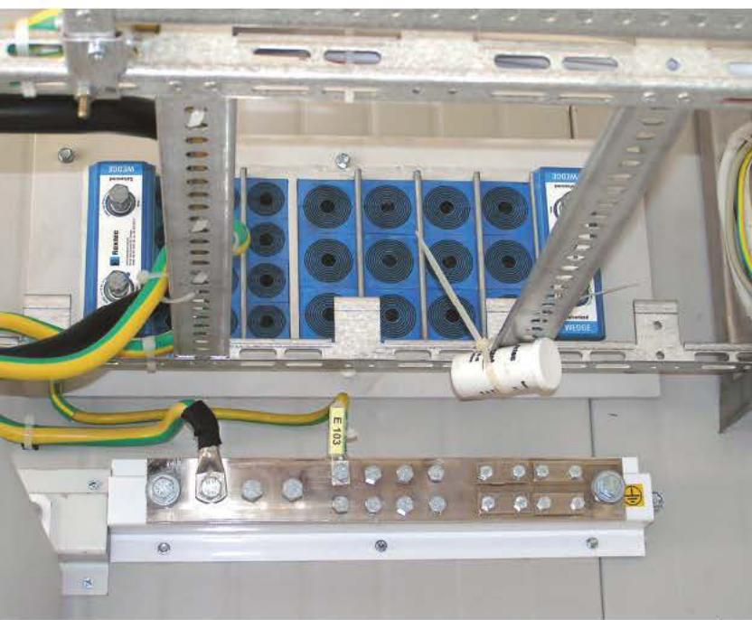
▼ otvor u zidu sa uvodnicama Roxtec
