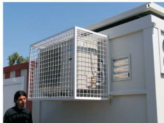
▲ nosač i zaštitna rešetka za klima uređaje
